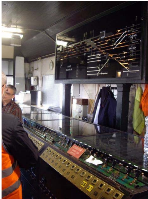
L'interno della cabina A
